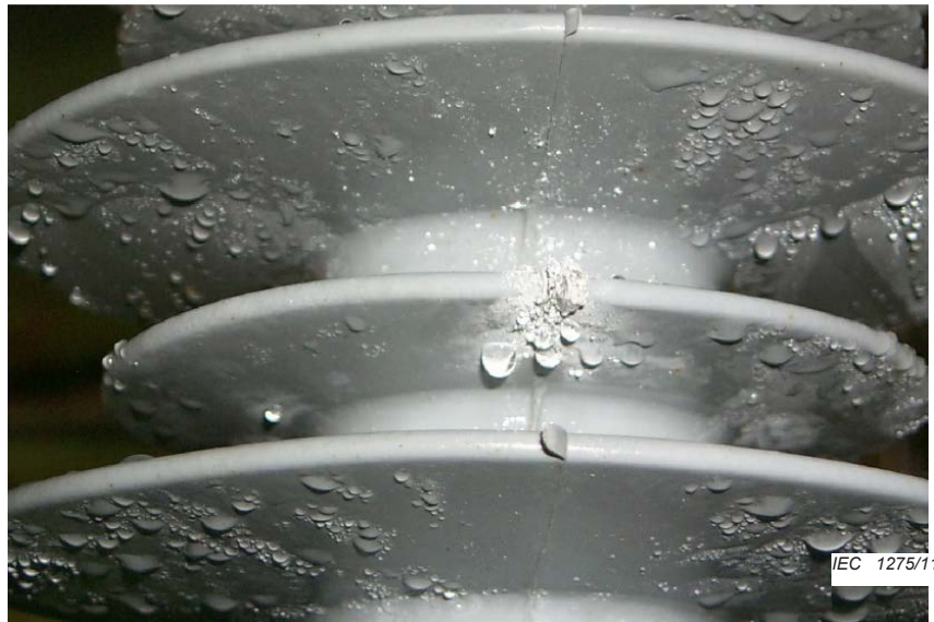
Figure A.37 – Impact des UV et de l'humidité après 11 ans de service
