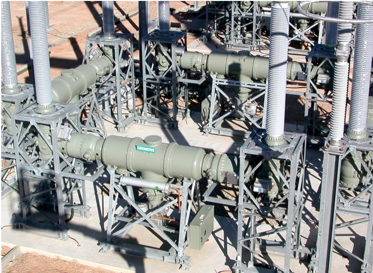
Figure A.32 – Sous-station – Installation en extérieur
